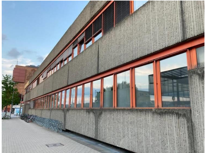
Abb. 6 (rechts): Spalten in Fassade über Roll-ladenkästen am Postgebäude, ohne Befund
